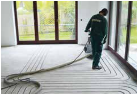
Nahezu staubfreie Kanalfräsung in den bestehenden Estrich durch erfahrenes Montageteam gemäß Verlegeplanung
